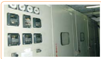
電子式電表裝置於變電所內
